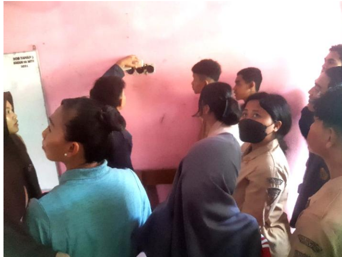
Gambar 3. Perbaikan sambungan kabel-kabel pada stop kontak dan dua buah saklar ganda di ruang kelas.
