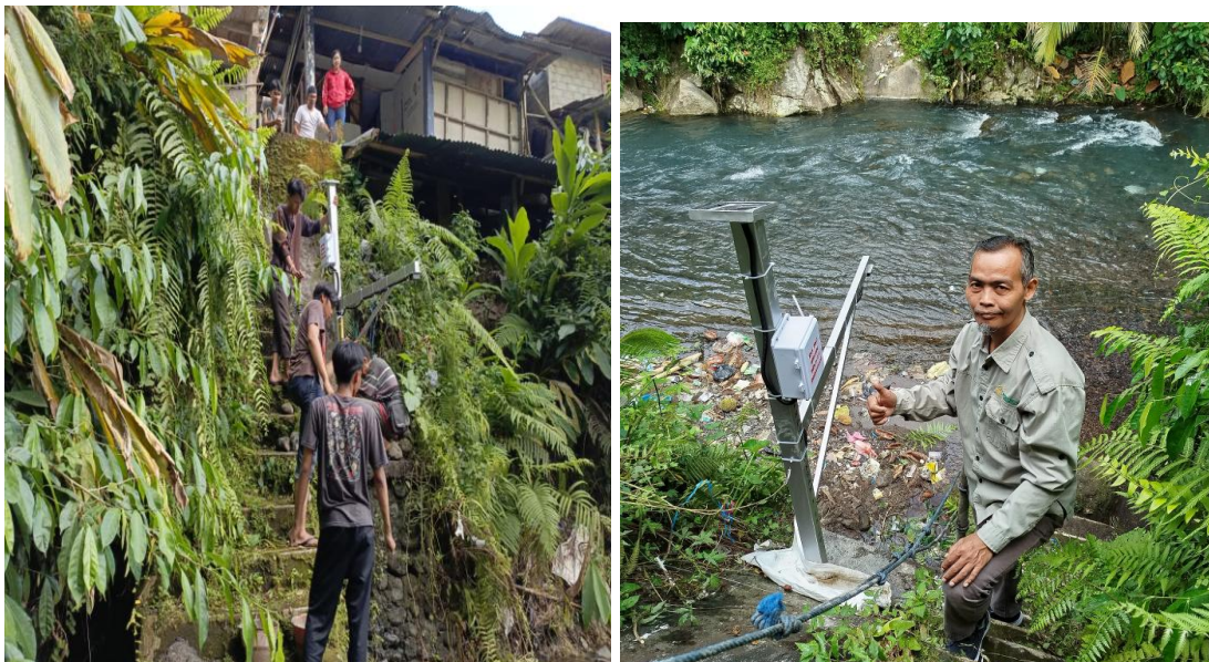
Gambar 2. Instalasi perangkat sensor sistem pada bantaran hulu sungai desa Sesaot.
