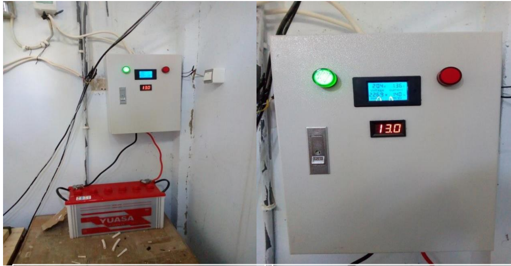
Gambar 6. Inverter yang telah terpasang
